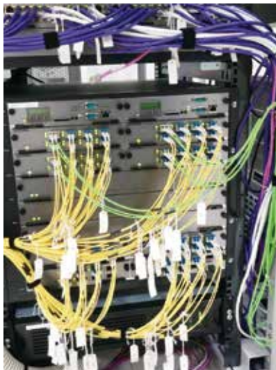
通信制御装置と 通信用光ファイバケーブル
